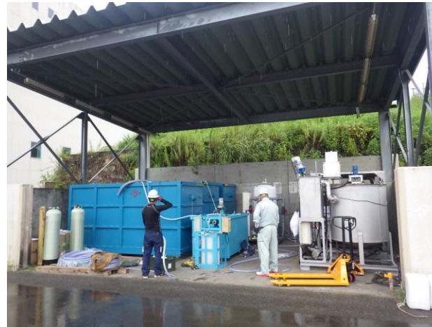
排水処理施設
