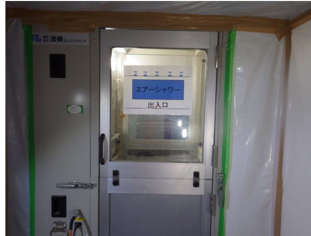
エアシャワー室
