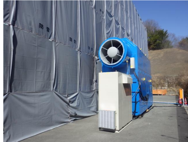
負圧集じん機設置状況
